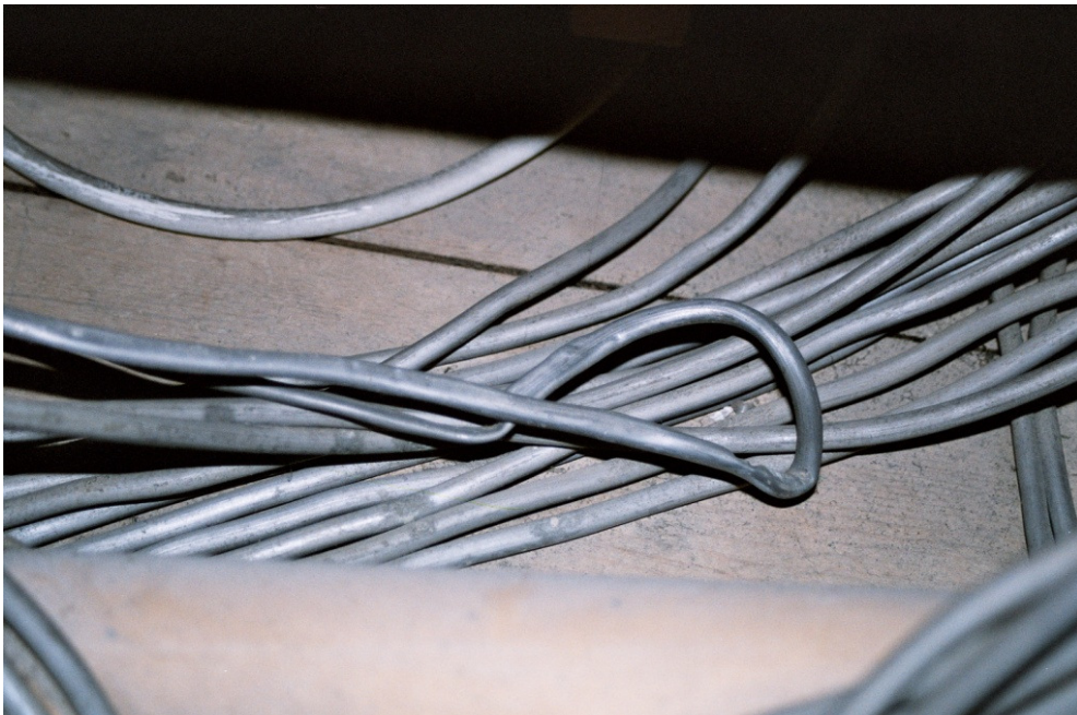
Das zerdrückte Bleirohr (Foto: Bernhard Hörler 2009)
