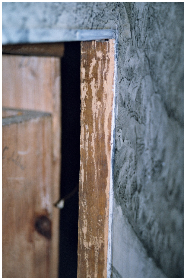
Reste eines vorherigen Anstrichs in Niederrickenbach (Foto: Bernhard Hörler 2009)
