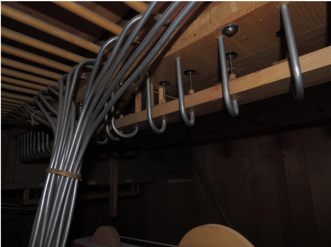
Die sauber verlegte Pneumatik (Bernhard Hörler)
